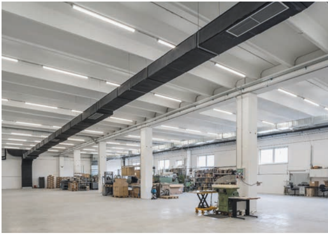
Für Produktionsstätten, Industriebereiche und -hallen, wie etwa hier bei Pladent in Slowenien, bietet SITECO vielfältige Lösungen: von leistungsstarken Lichtbändern über robuste Feuchtraumleuchten bis hin zu effizienten Hallenleuchten.
